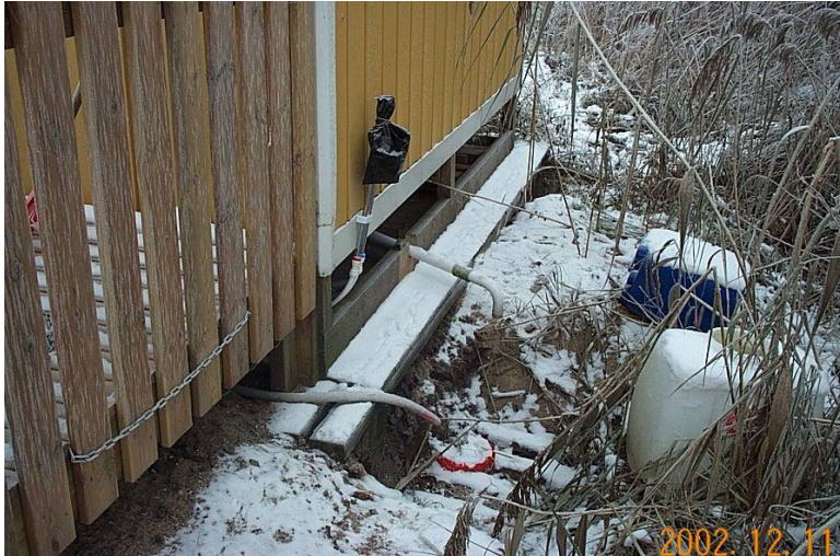
Egenhändigt ordnat avlopp som rinner ut i närmsta dike.
